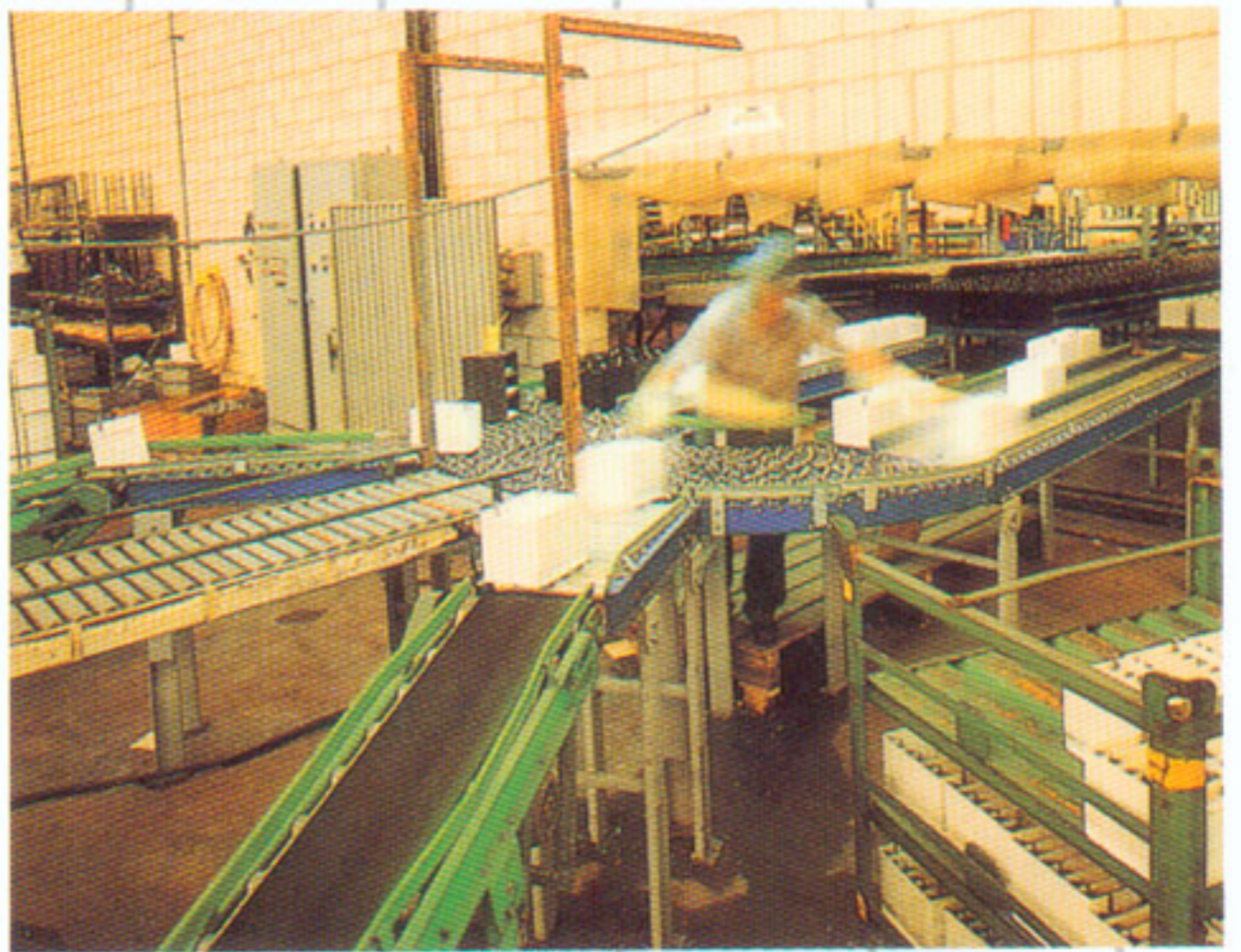
Instalación para industria de acumuladores.
