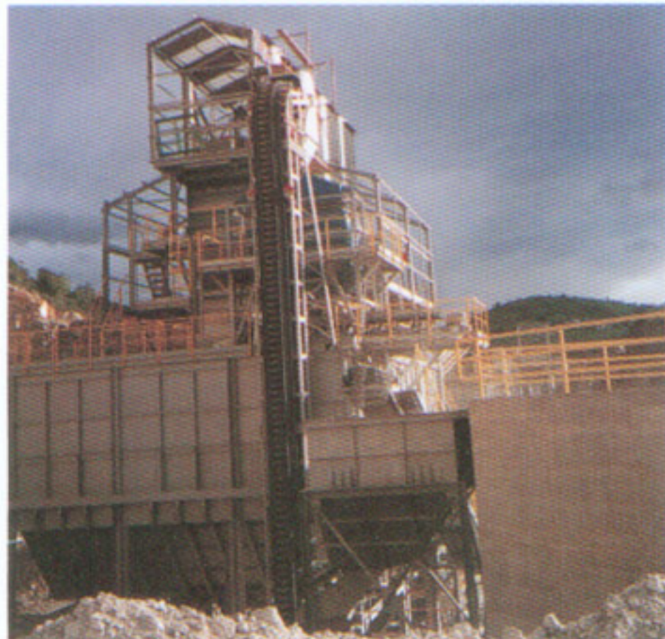
Elevador TEB en instalación de tratamiento de áridos.
