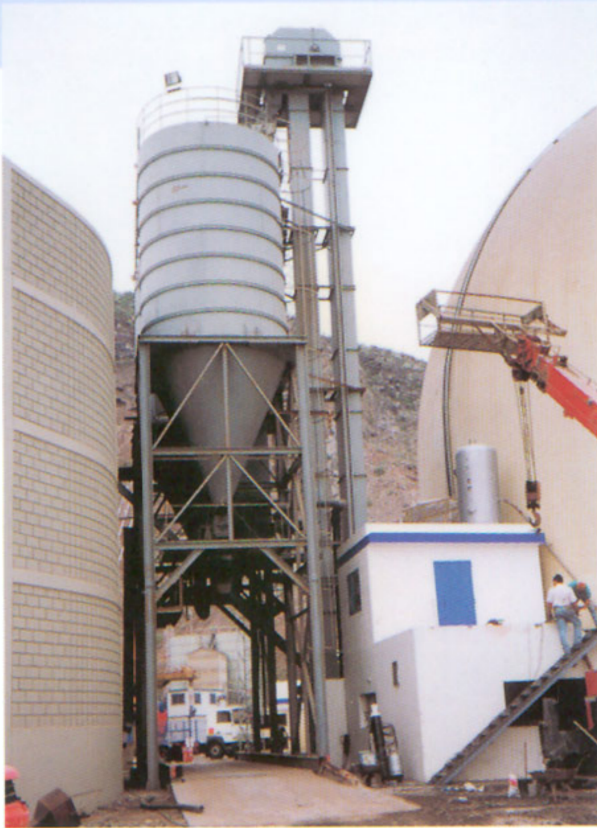
Instalación TEC para almacenaje de cemento en silo.
