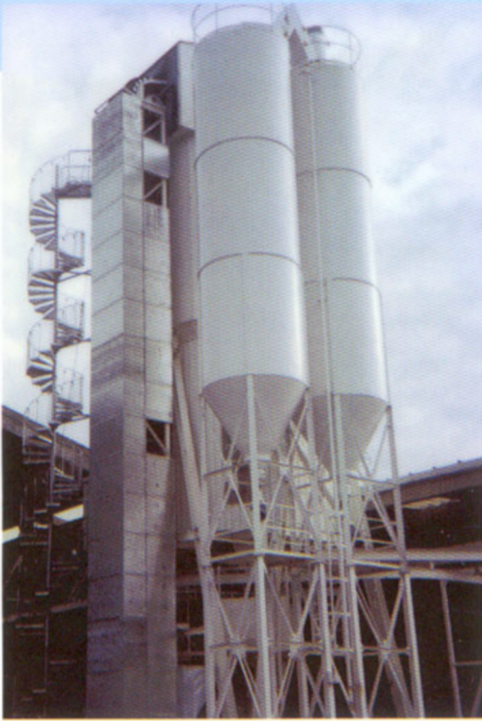
Elevador TEB con distribuidor a celdas de silos con altura de 25 m.
